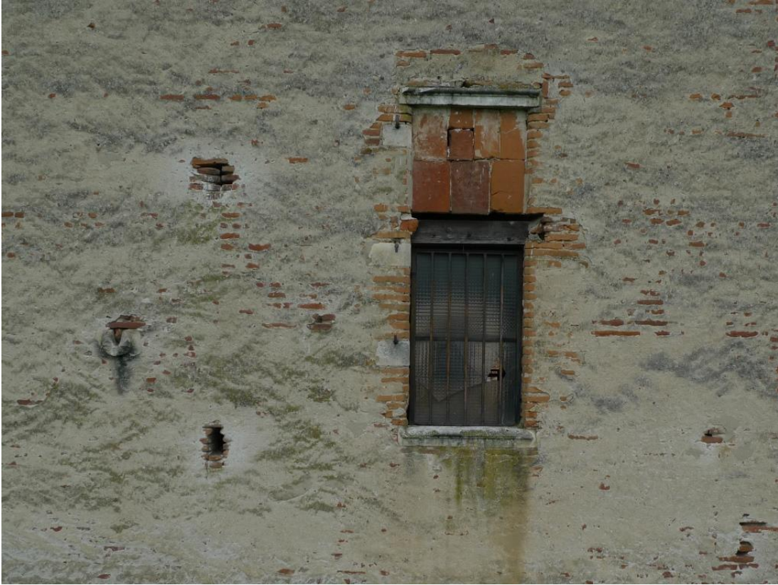
Fig. 46 : Fenêtre demi-croisée (2805) dont le croisillon a été remplacé par une poutre métallique.
