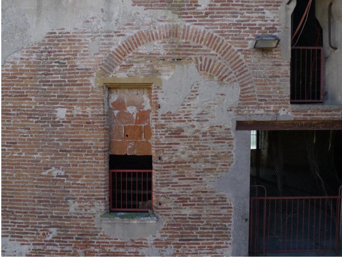
Fig. 53 : Ancienne fenêtre jumelée remplacée par une demi-croisée (FEN 2503) au 1 er étage de la façade 1114.
