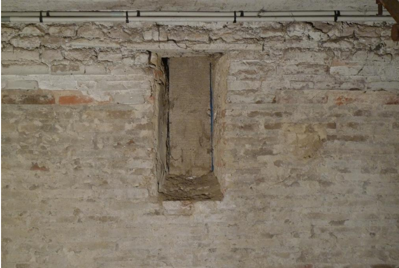
Fig. 82 : Jour 1507 ayant détruit la corniche moulurée.
