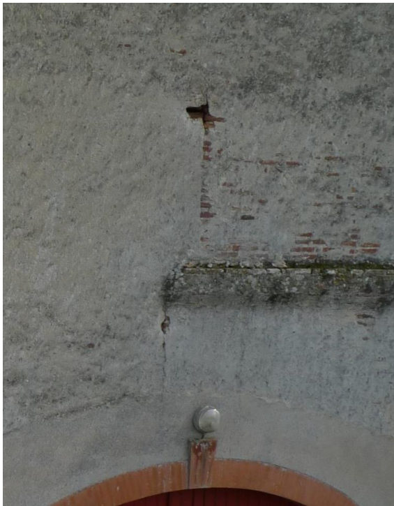
Fig. 49 : Ligne de reprise au-dessus du portail principal.
