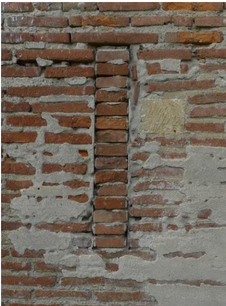
Fig. 40 : Fente de jour bouchée (1304)
