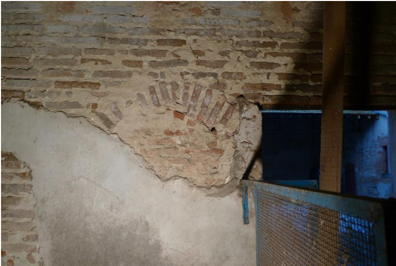
Fig. 83 : Niche bouchée 1506 partiellement détruite
