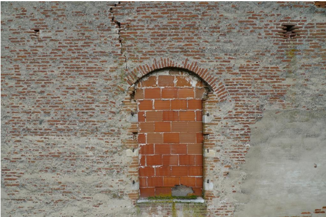
Fig. 47 : Fenêtre jumelée (2612) détruite et bouchée dont ne subsiste que l'arc de couverture. On remarque une réduction de l'ouverture suite à son remplacement par une croisée détruite elle aussi.
