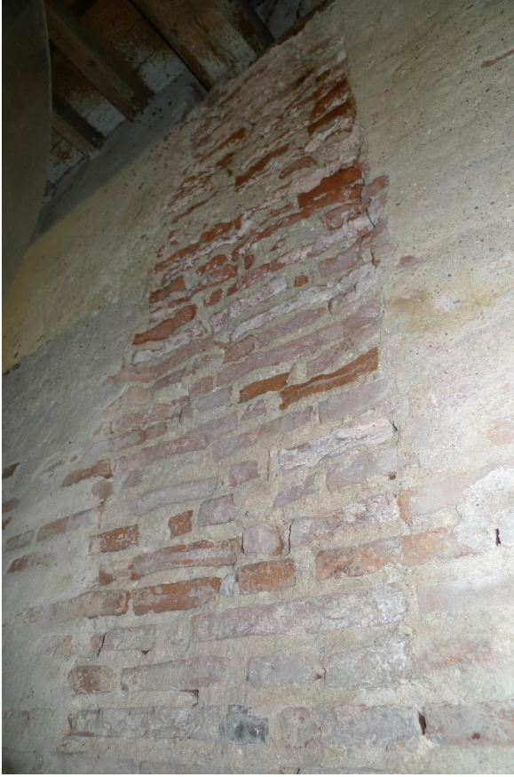
Fig. 94 : Arrachement sur le mur ouest 1801.
